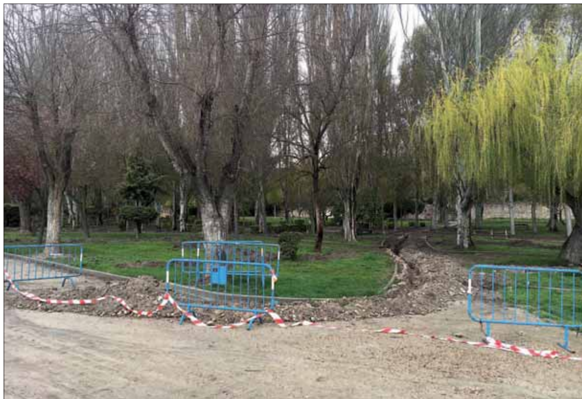
Se han realizado zanjas en toda la parte central del parque para automatizar el riego. / CHANTAL NÚÑEZ
