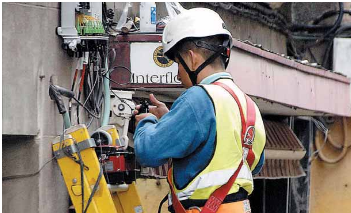
Un operario desarrollando labores de instalación de fibra óptica en una calle de Segovia. / JUAN MARTÍN
