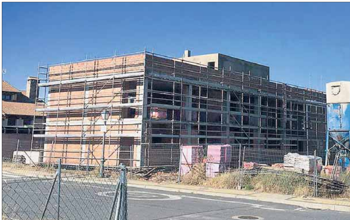
A lo largo de 2016 se pretende ejecutar la segunda fase de construcción del centro social de Robledo. / EL ADELANTADO
