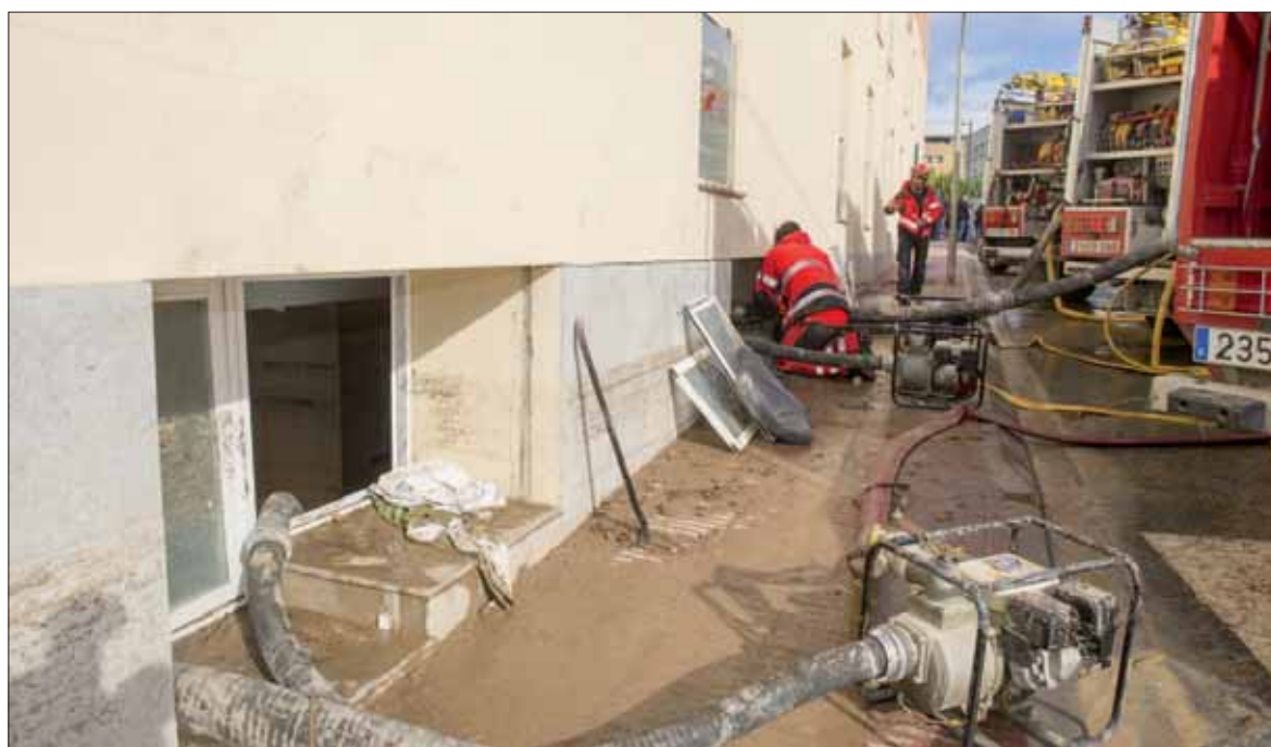
Los bomberos y el resto de efectivos de emergencias se ocuparon de extraer el agua del interior de la residencia. / EFE
