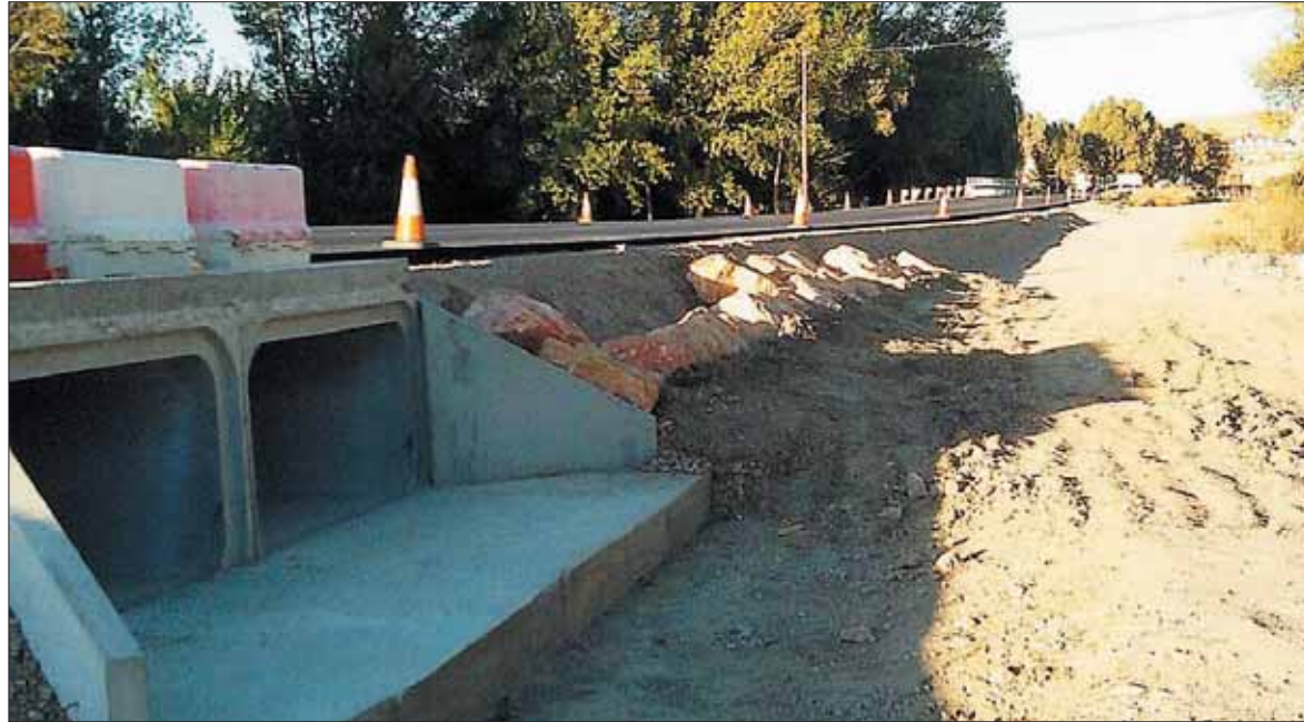
Las obras han consistido en la elevación de la rasante de la carretera. / EL ADELANTADO
