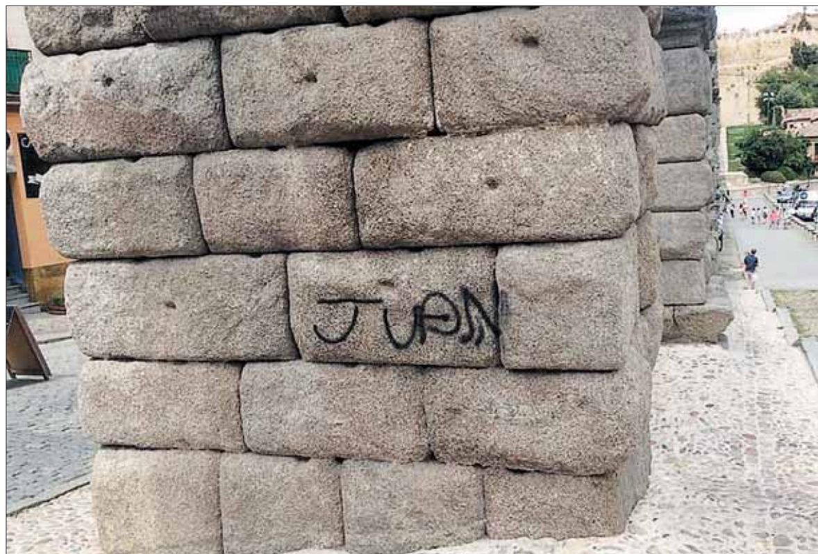
La Policía Nacional investiga la pintada vandálica realizada en uno de los sillares del Acueducto. / EL ADELANTADO
