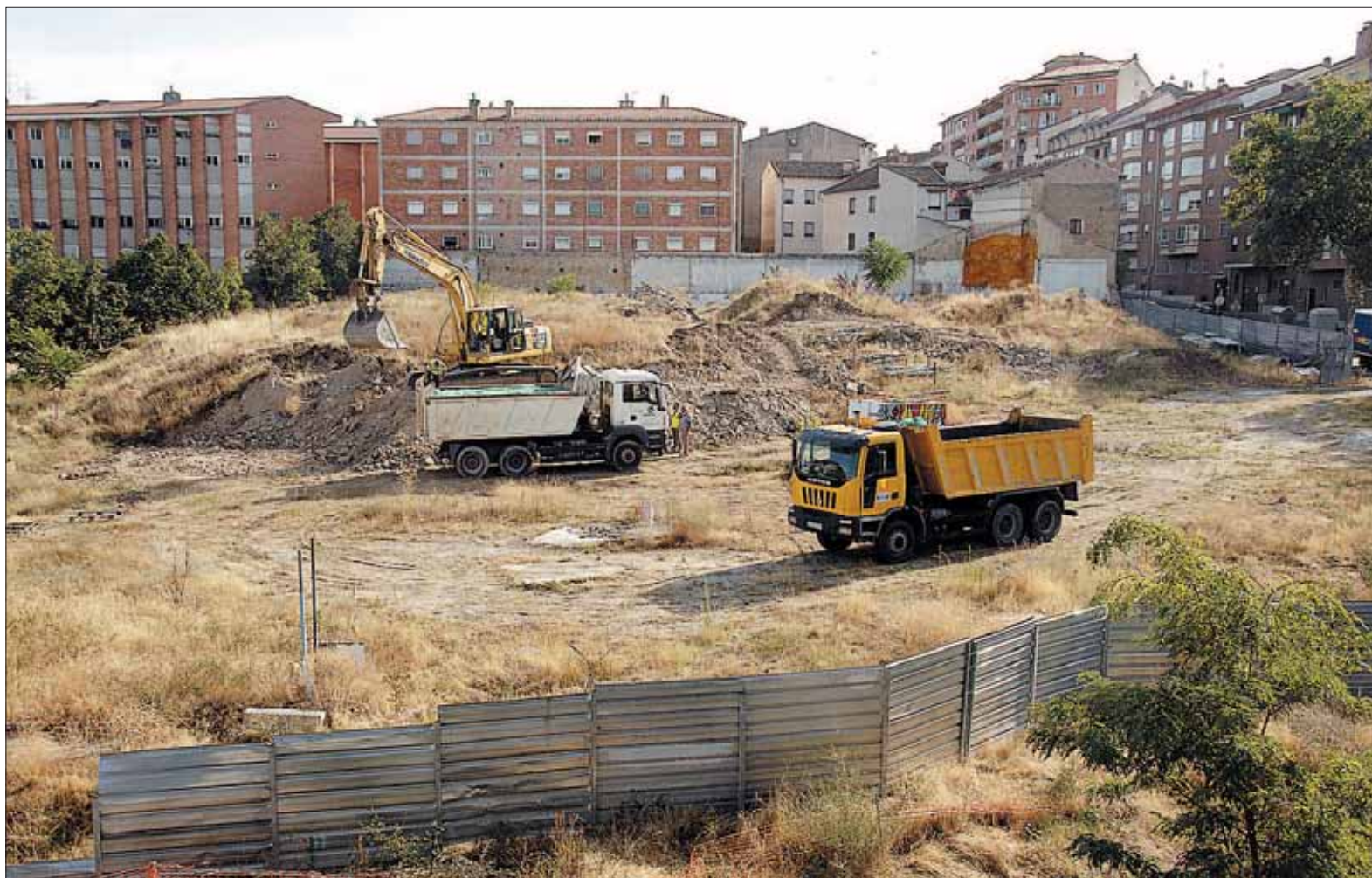
Primeras labores de eliminación de maleza, retirada de escombros y explanación del solar donde se edificará la mitad del campus de la UVa. / JUAN MARTIN
