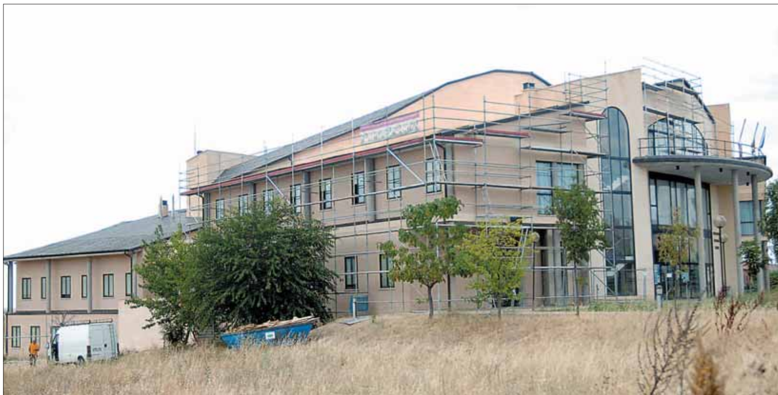
La cubierta del Conservatorio ha dado problemas desde la apertura del edificio en el año 2002 y ha requerido varias reparaciones; este verano, la cuarta. /ELENA PEÑA
