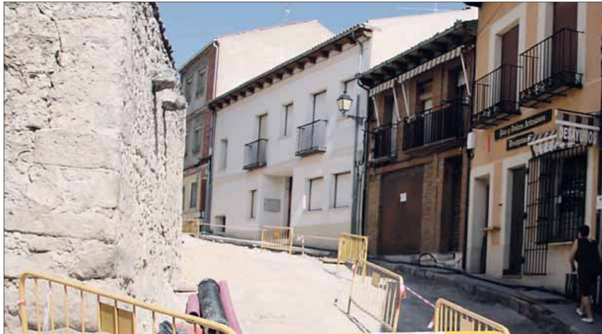
Estado de la calle San Esteban actualmente mientras se ejecutan las obras de adecuación. / C.N.
