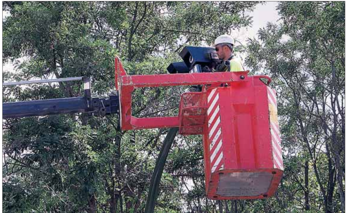
Los operarios ya han instalado el sistema de semáforos 'foto rojo' en la travesía de San Rafael. / PEDRO MERINO
