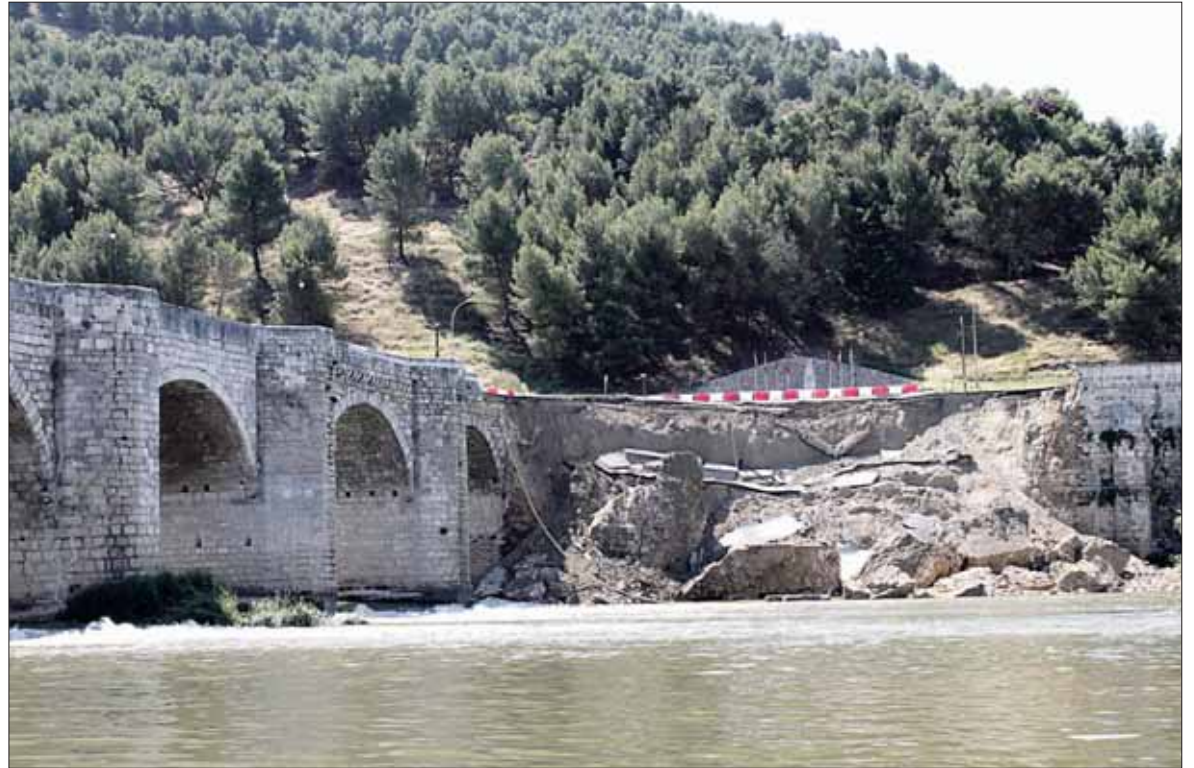
El Consistorio de la localidad vallisoletana asegura que la estructura central del puente está menos afectada. / EFE
