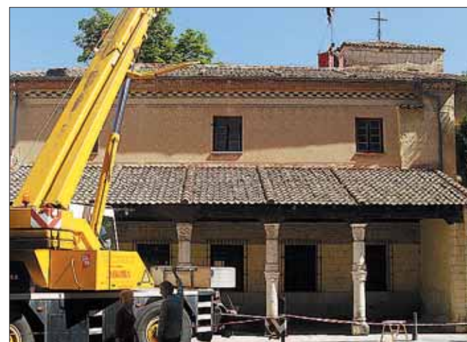
El tejado del edificio de San Nicolás está siendo reparado. / EL ADELANTADO
