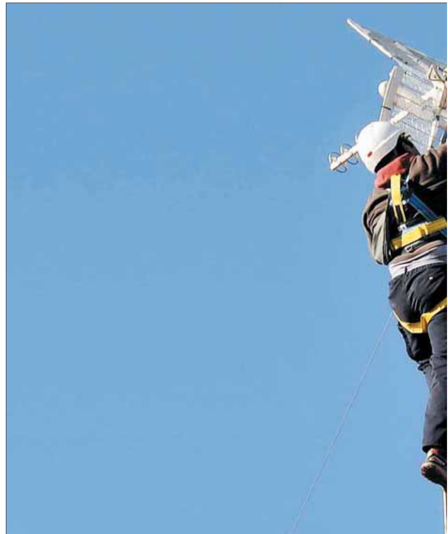
Un instalador trabajando en una antena situada en un edificio de Segovia capital. Aseitel calcula
