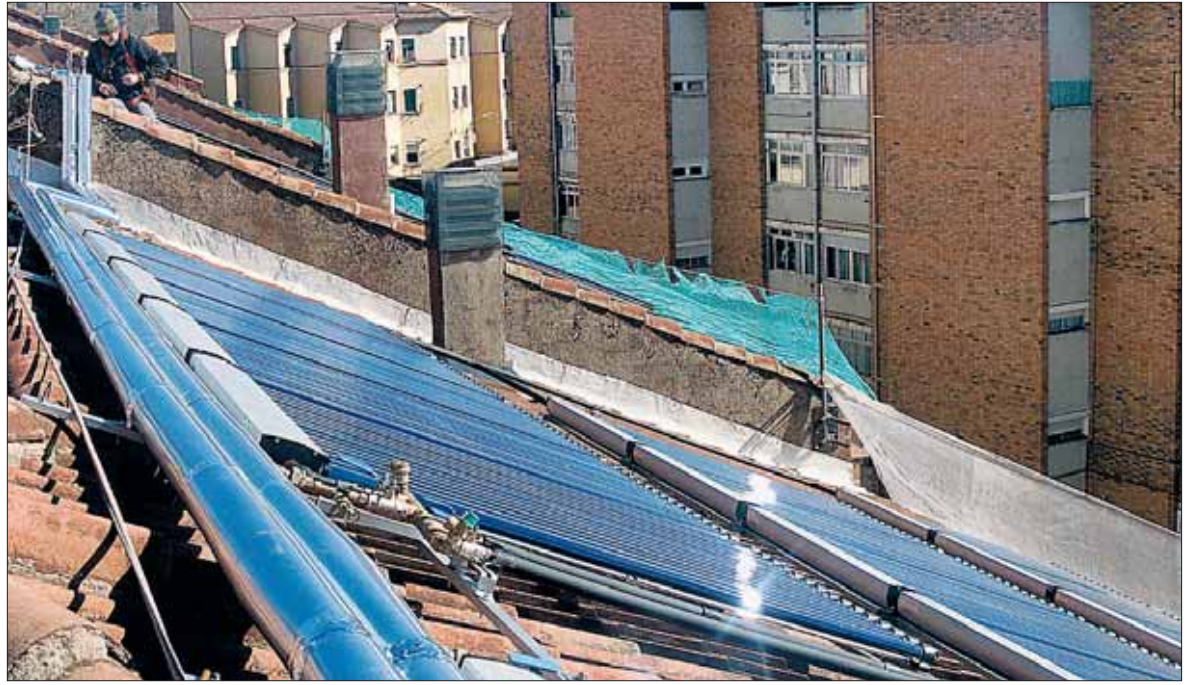
Tejado de uno de los edificios de la calle Larga donde se han colocado los captadores. / GUILLERMO HERRERO
