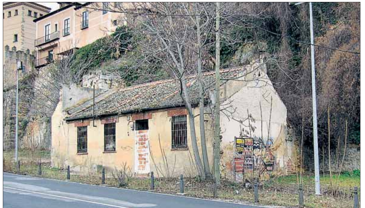
El inmueble, que se construyó en 1930, en estado de ruina, será demolida próximamente. / EL ADELANTADO
