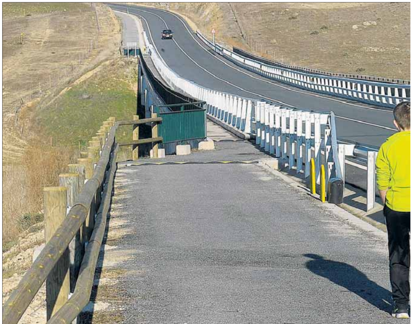
El vial de Palazuelos de Eresma es el proyecto más importante que ha ejecutado del Área de Acción Territorial en el mandato actual, con un
