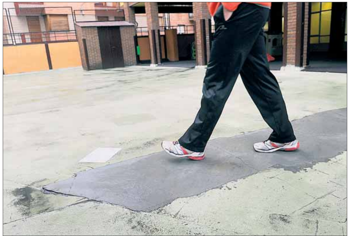
El patio destinado a los alumnos de Infantil tiene grietas y parches que provocan tropezones y caída a los niños. / KAMARERO
