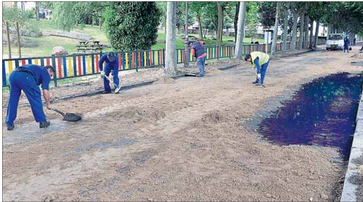
Operarios municipales, limpiando el pasado mes de julio la calle tras el accidente del camión. / PEDRO MERINO
