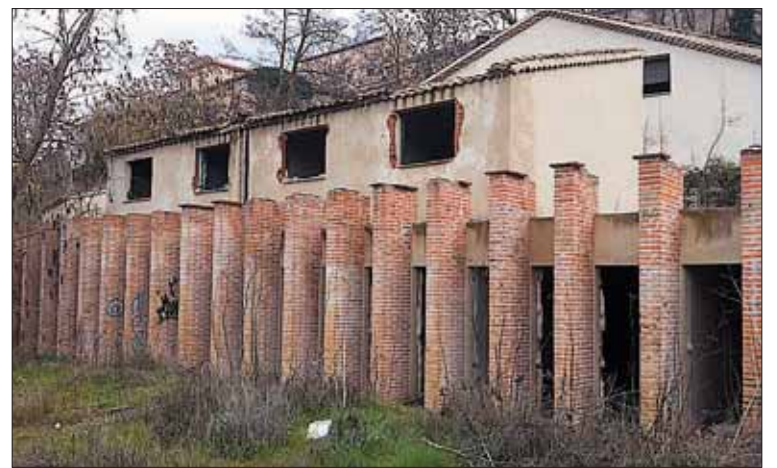
En un muro de contención se intentaron camuflar 46 minipisos. // J. MARTÍN
