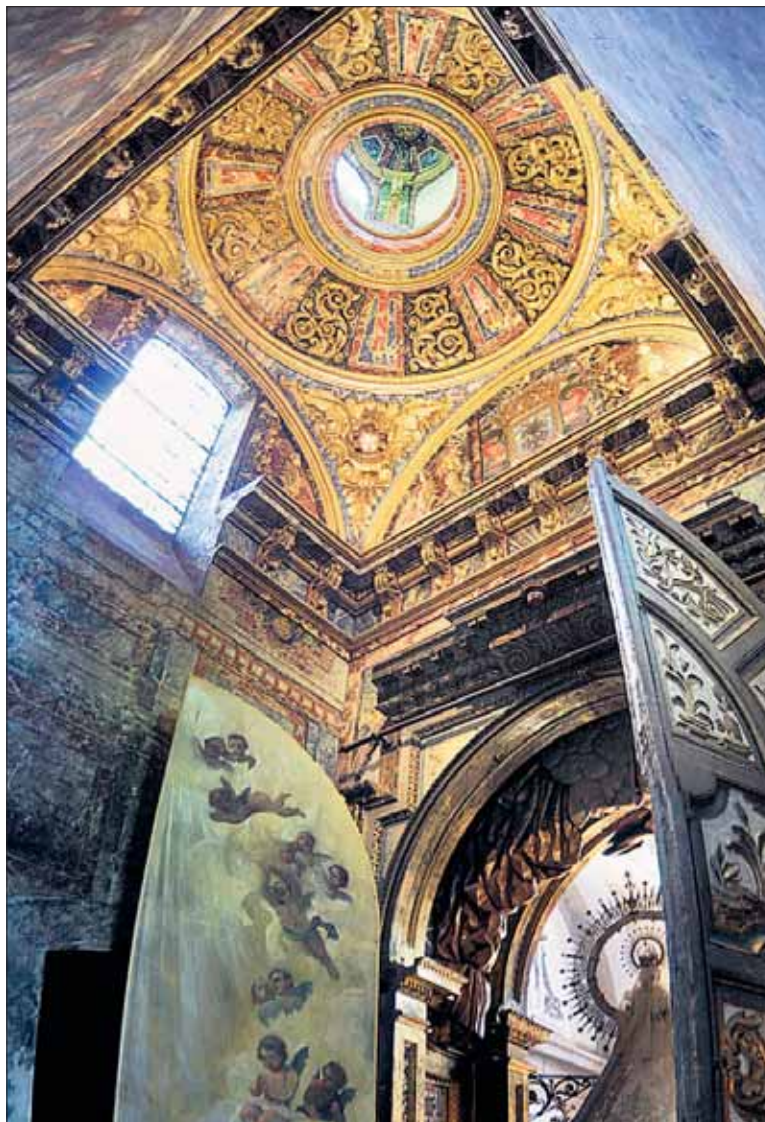
La bóveda del camarín de la virgen sufre de grietas y humedades. / KAMARERO
