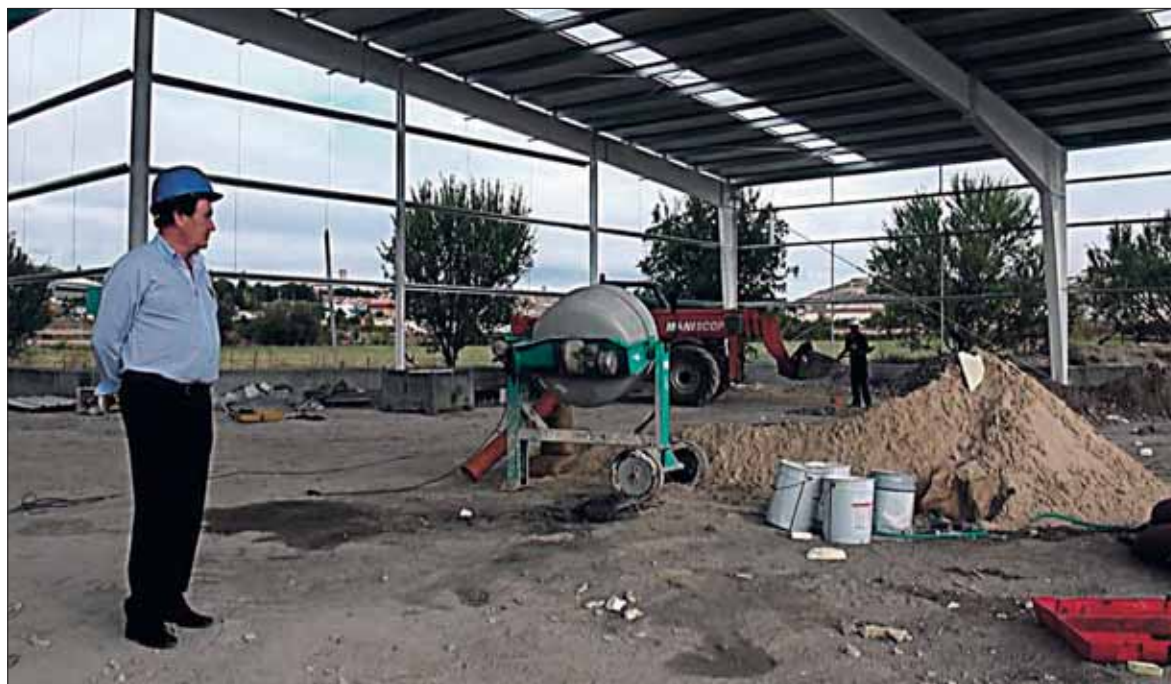
El alcalde Jesús García Pastor en las obras de la nave de servicios del Polígono Malriega. / EL ADELANTADO
