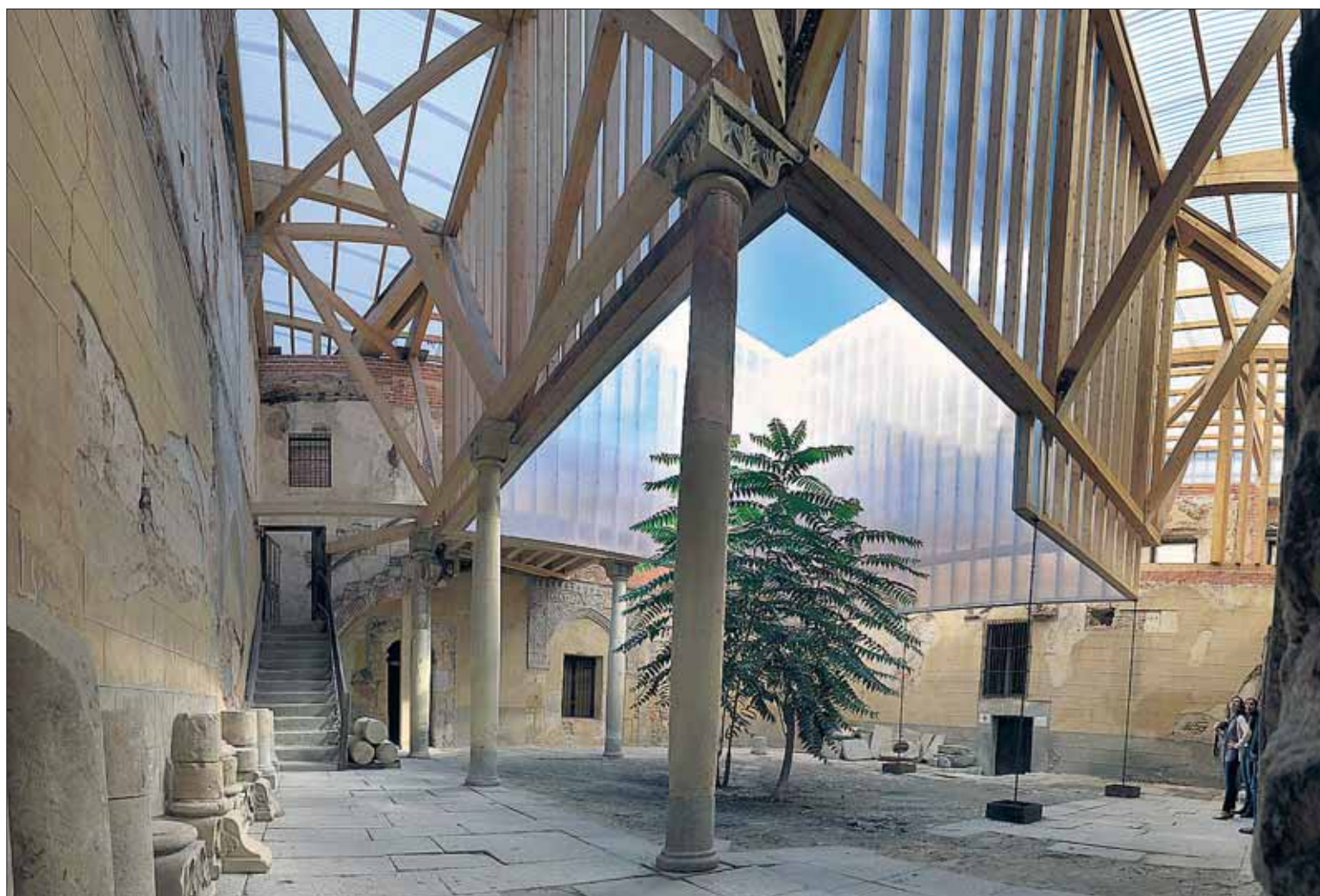
La estructura que sostiene los muros perimetrales de la fachada sirve también para proteger los forjados originales del palacio. / KAMARERO
