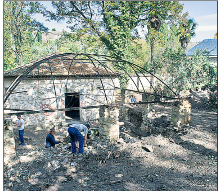
Varios operarios trabajando en el jardín de la Casa de la Moneda. / KAMARERO
