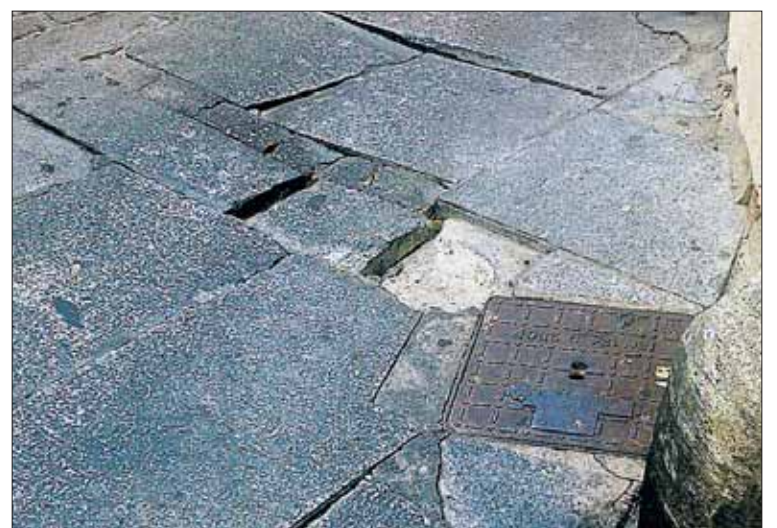
Estado en que se encuentra la acera de la calle Valdeláguila. / EL ADELANTADO
