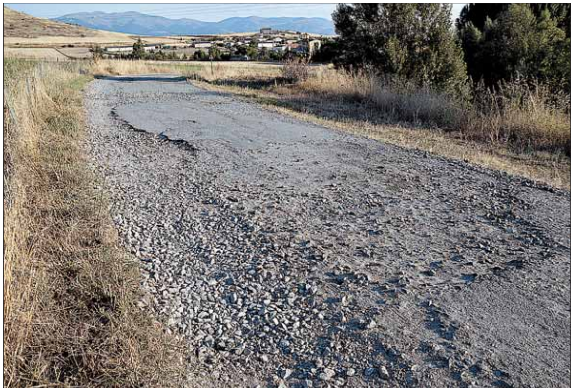
Los vecinos reivindican el arreglo del acceso que enlaza con la carretera de Arévalo. / JUAN MARTÍN
