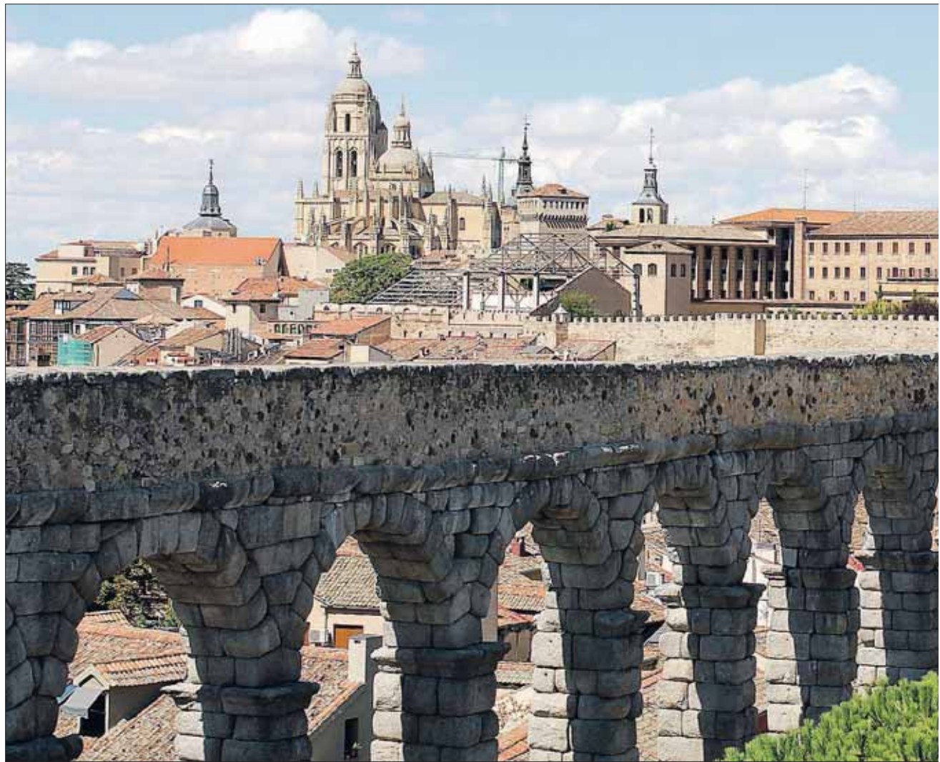
La segunda fase de intervención en el Acueducto consistirá en la retirada del canal de plomo instalado en los años 90 así como el rejuntado
