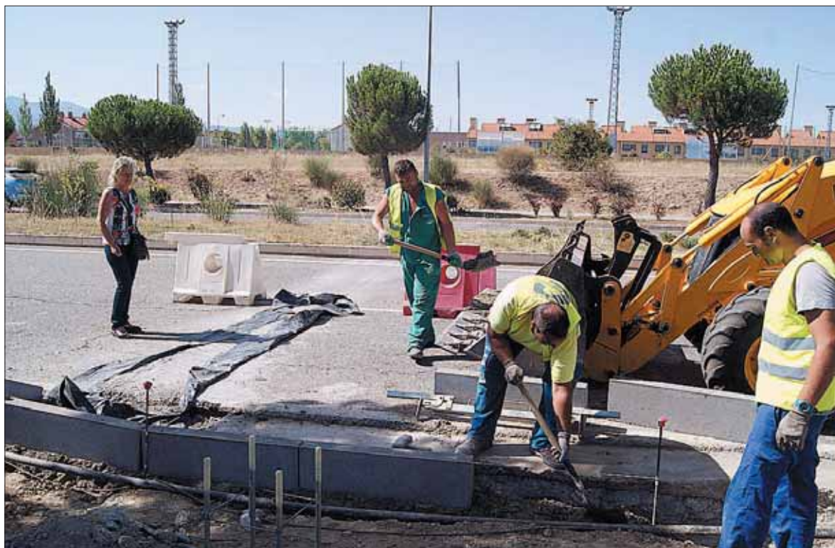
La concejala de Tráfico, Paloma Maroto, visitó ayer las obras en Nueva Segovia. / EL ADELANTADO
