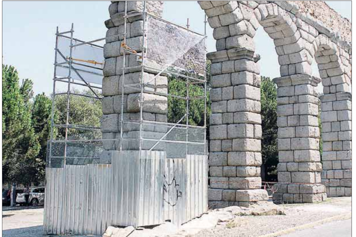
La valla ciega situada en torno a los andamios de la plaza de Avendaño tiene dos metros de altura. / FRAN MUÑOZ
