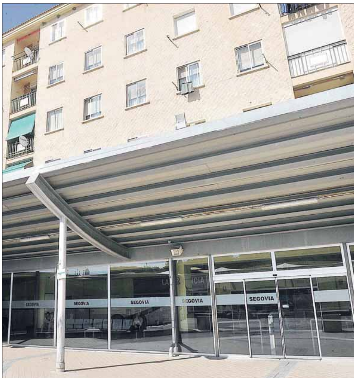
La marquesina deberá ser 'demolida' en su totalidad y el Ayuntamiento tiene que asumir el coste de su retirada. / KAMARERO
