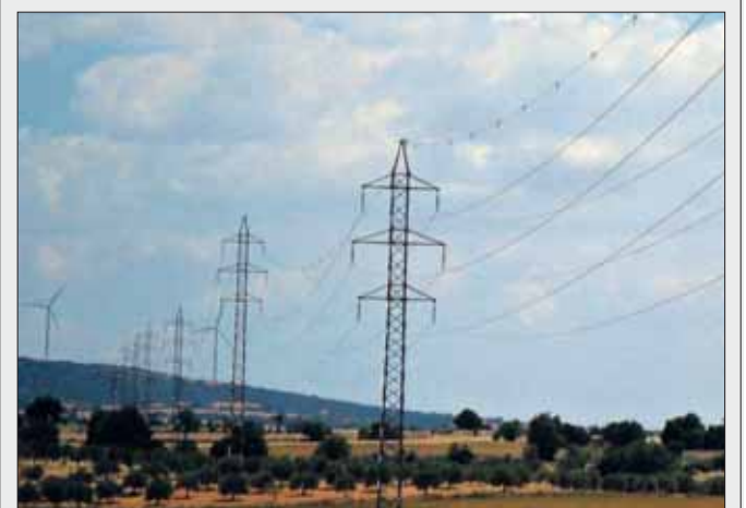
Línea eléctrica de alta tensión. / EP.
