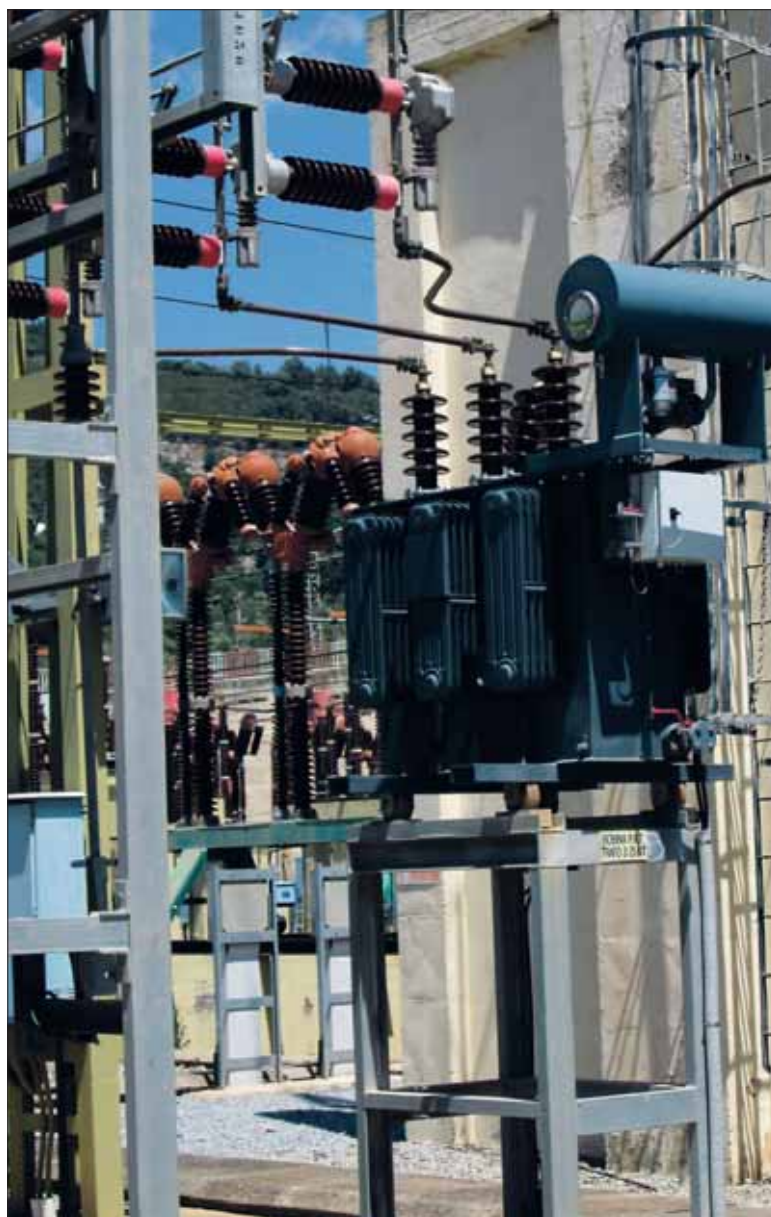
Detalle de la subestación de Sant Just Desvern, de Endesa. / EP.
