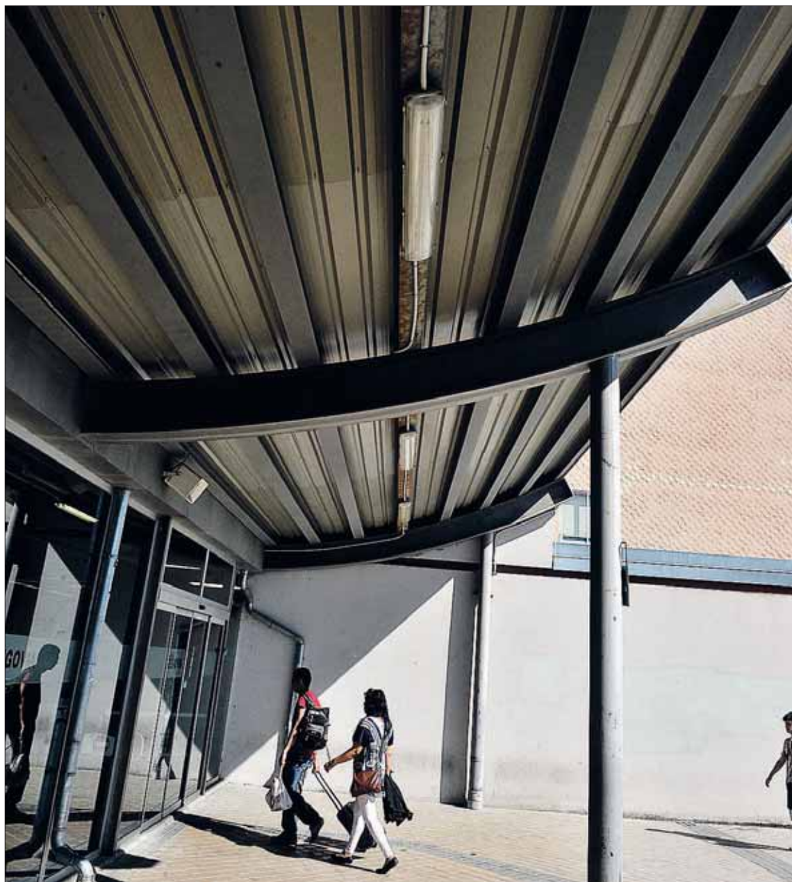
El último auto judicial recuerda que la marquesina debe ser demolida "en su totalidad". / KAMARERO
