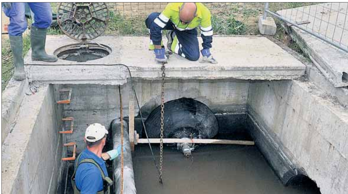
Operarios municipales trabajaron intensamente en la tubería averiada durante toda la jornada del miércoles. / KAMARERO
