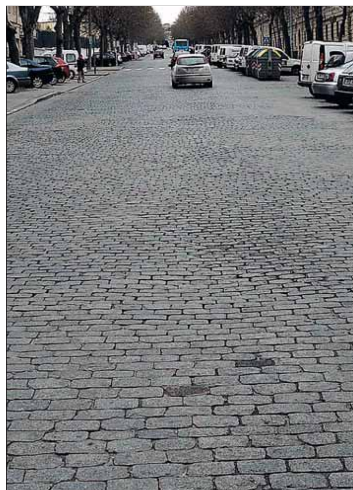
La avenida, con firme de adoquín, presenta un galopante deterioro. //J.M.
