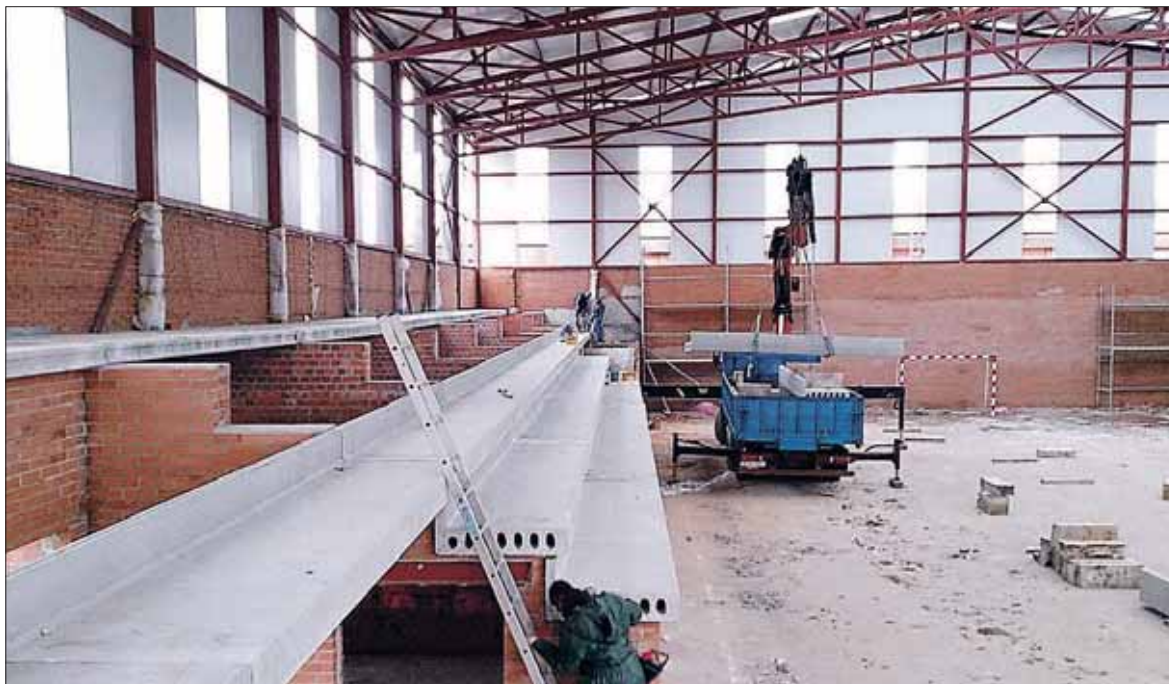
Obras de la tercera fase del pabellón polideportivo de Navalmanzano, anejo al colegio "Miguel de Cervantes". / EL ADELANTADO
