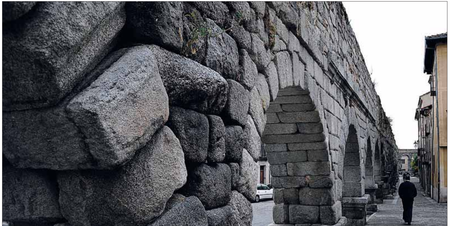
La zona del Acueducto próxima a la Plaza de Día Sanz será una en las que se acometerán en una primera intervención. / KAMARERO
