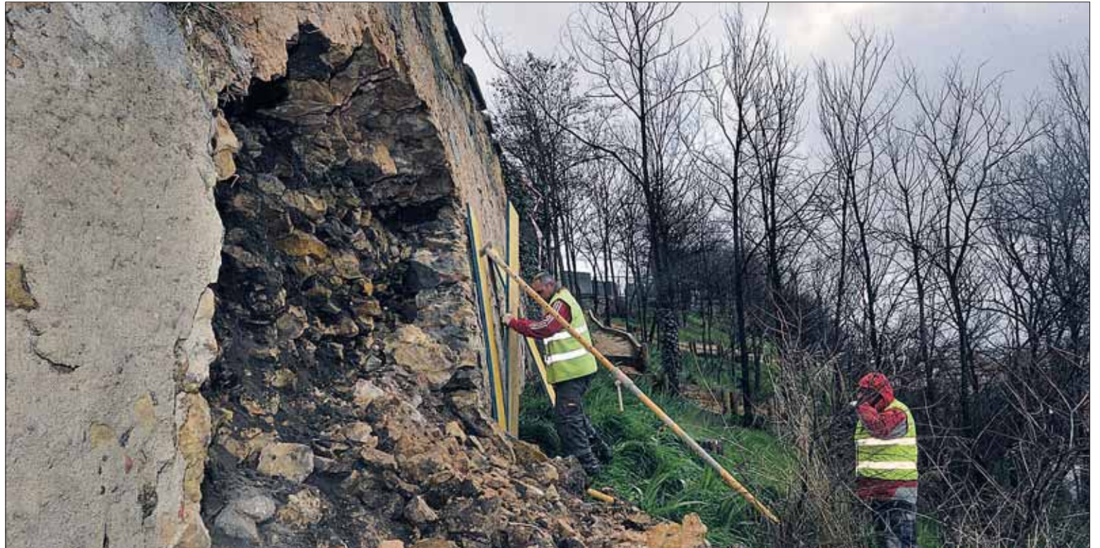
Dos operarios, trabajando ayer en el muro derrumbado en la calle de Los Tilos, un suceso que obligó al Ayuntamiento a cortar el tráfico por la zona. / KAMARERO
