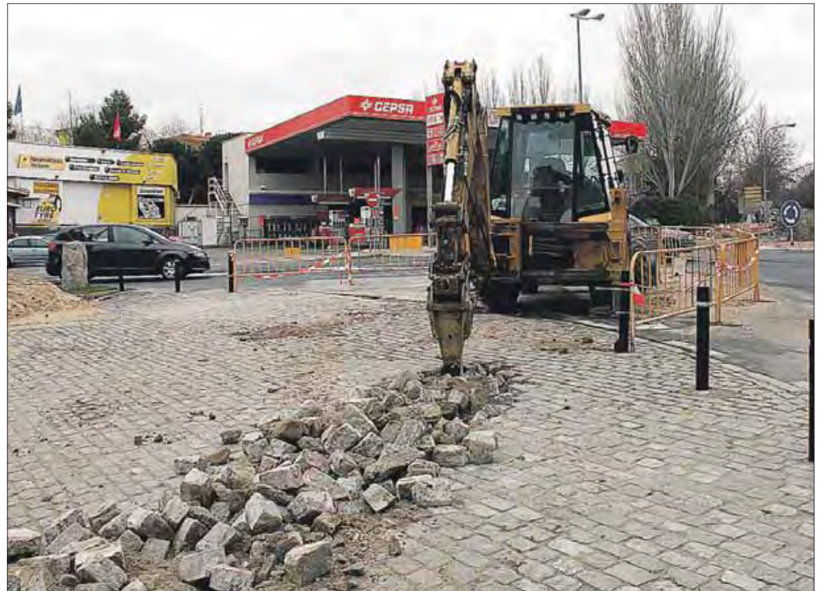
Las obras han comenzado en la zona más próxima a la Base Mixta. / M.G.
