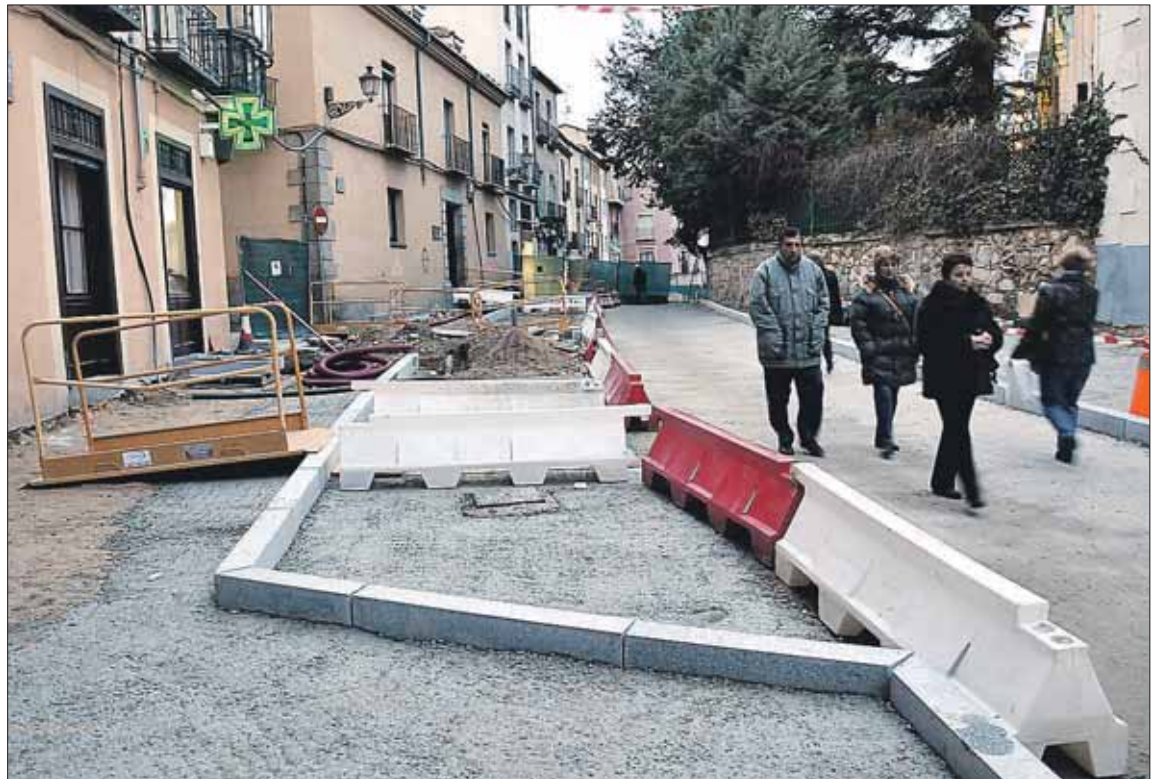
La segunda fase de las obras del eje Muerte y Vida-San Francisco supondrá una inversión superior a los 194.00 euros. //J.M.
