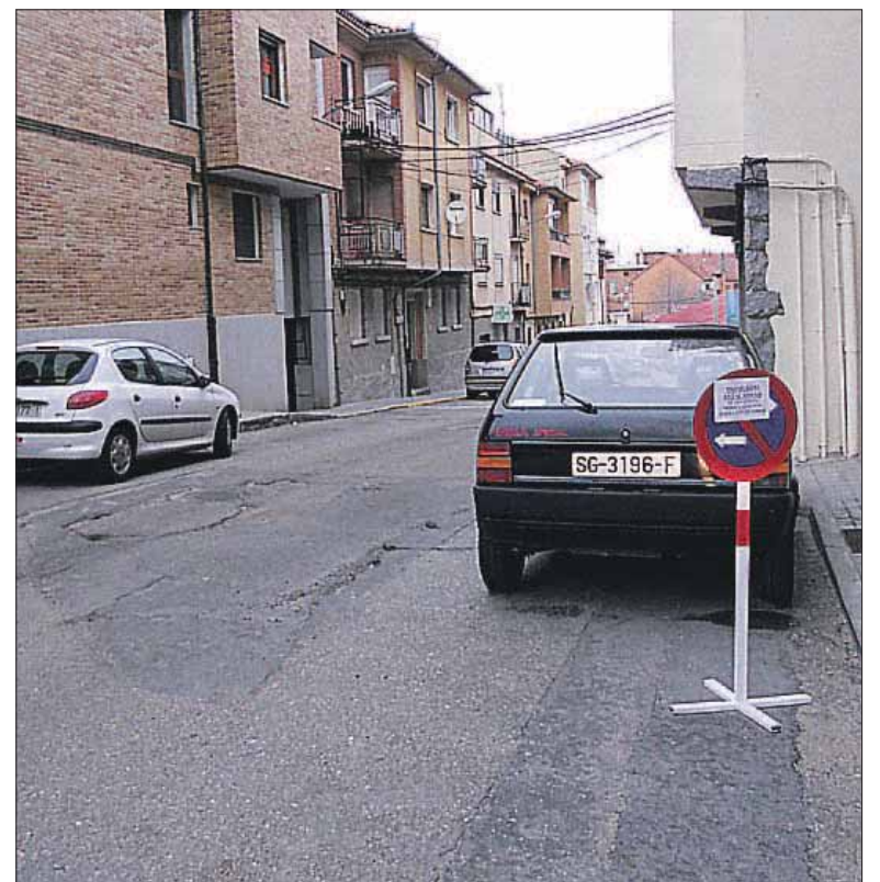
La señalización de los trabajos ya ha sido instalada en la calle. / M.G.
