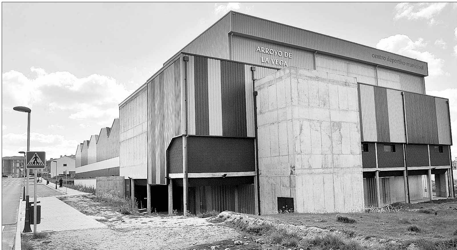
El pabellón polideportivo Arroyo de la Vega se ha ido deteriorando en los últimos años. / KAMARERO
