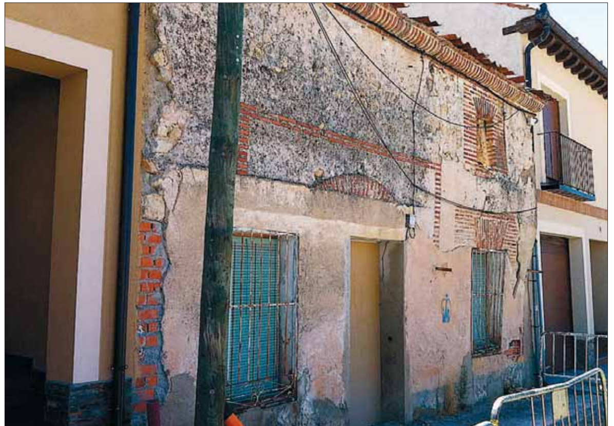
El edificio de la calle Sacramento, en su actual estado. / EL ADELANTADO
