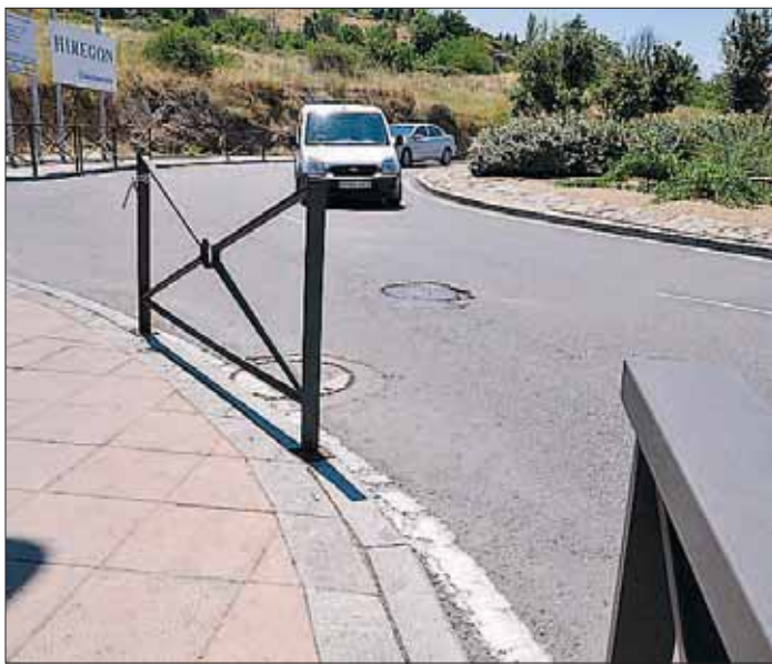
Las vallas se encuentran incompletas y deterioradas. / EL ADELANTADO
