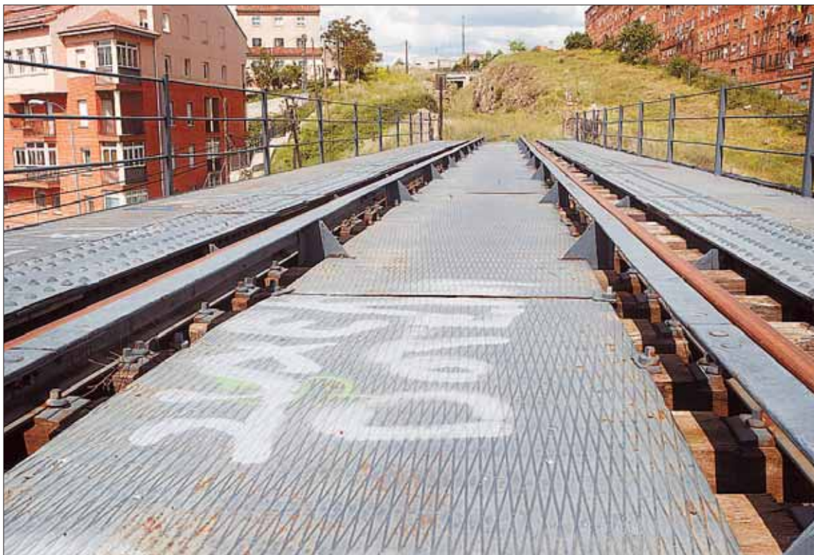
La vía verde parte del puente metálico sobre el Arroyo Tejadilla, en el Puente de Hierro. / KAMARERO
