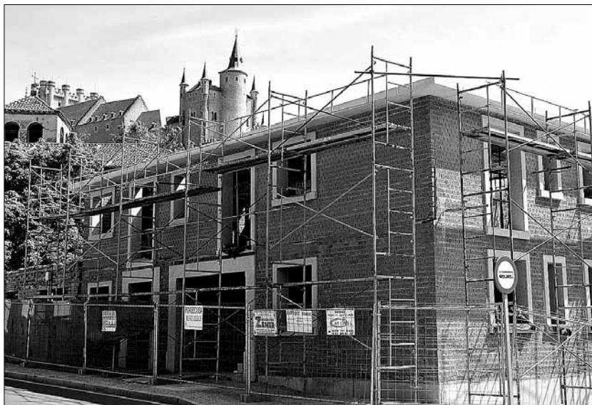
El polémico edificio en construcción se encuentra en el número 25 de la calle de San Marcos. / JUAN MARTÍN
