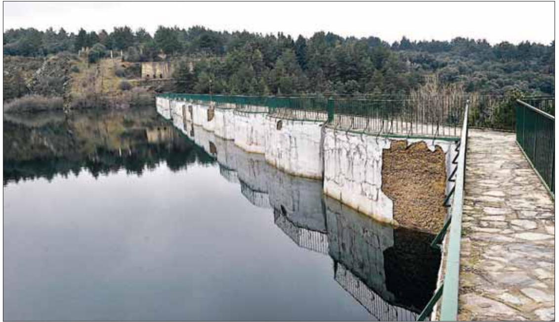
El Ayuntamiento de Segovia pretende que el recrecimiento de Puente Alta (en la imagen) permita triplicar la capacidad actual del embalse. / KAMARERO
