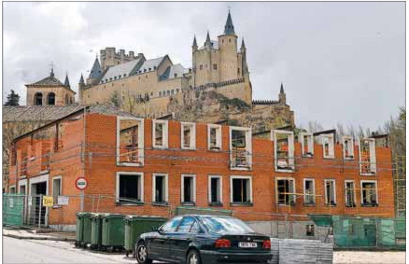
El polémico edificio en construcción se sitúa en la calle de San Marcos número 25. / KAMARERO
