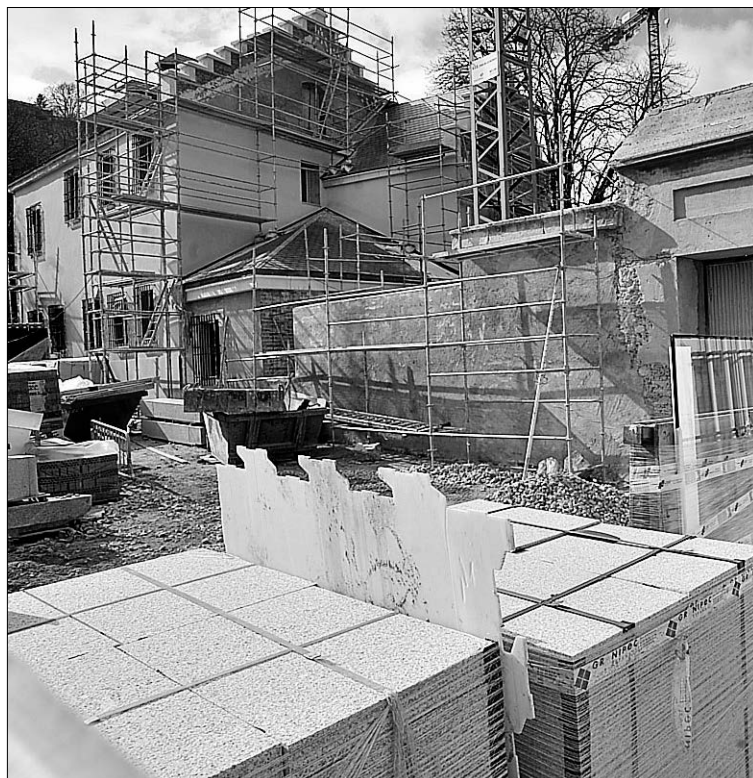
Imagen del interior de las obras de la Casa de la Moneda./WEB AMIGOS CASA MONEDA
