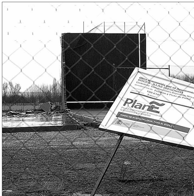
Vista del frontis del frontón, antes de su reciente caída. / G.HERRERO
