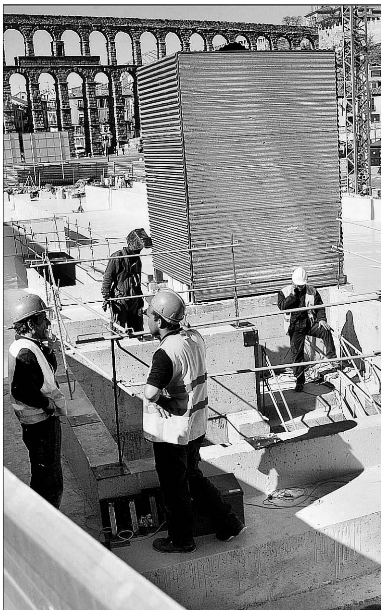
Una de las seis cabinas con ascensor para el acceso peatonal./KAMARERO
