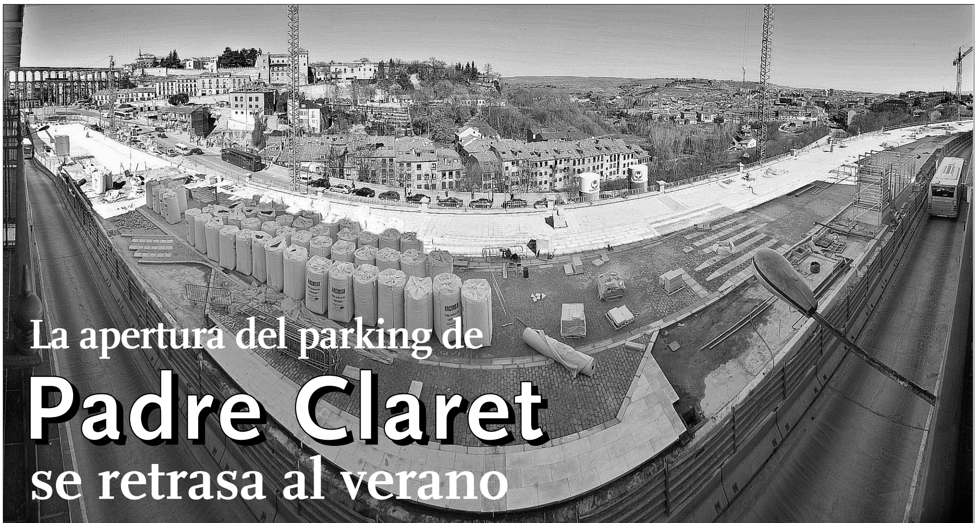
Imagen tomada desde "Hotel Acueducto" en la que puede apreciarse el estado actual de las obras de construcción del aparcamiento de Padre Claret, que ya será operativo el próximo verano./KAMARERO
