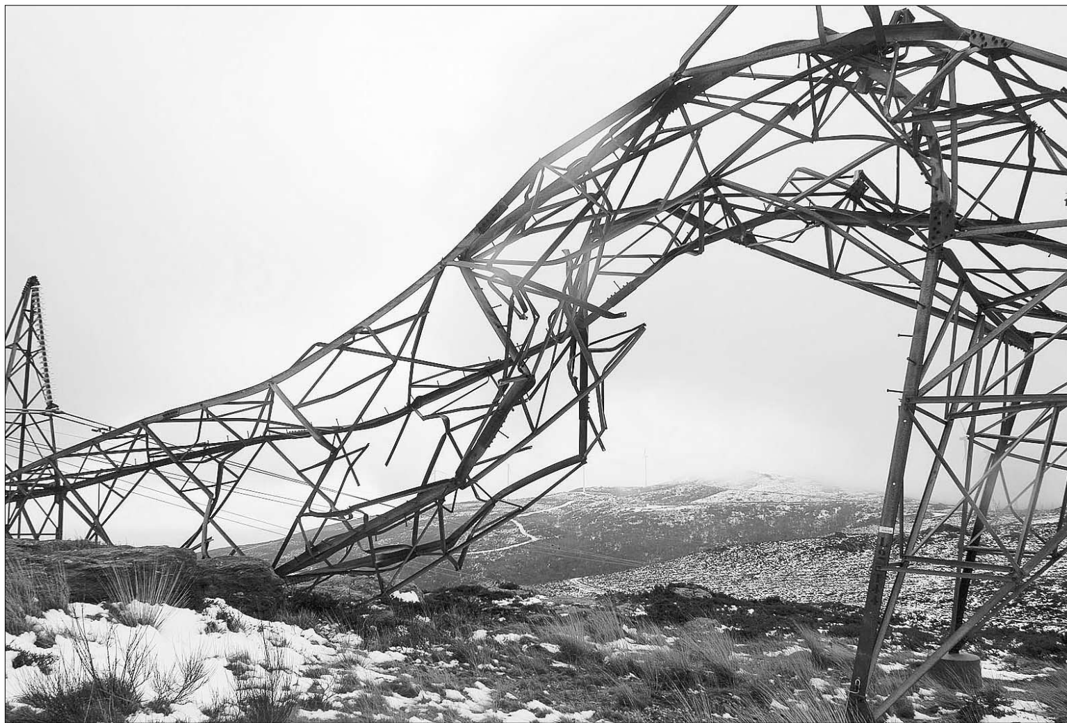
Una torre de alta tensión en el municipio pontevedrés de Lalín no pudo soportar la fuerza de los vendavales que azotan la zona. / ELISEO TRIGO (EFE)
