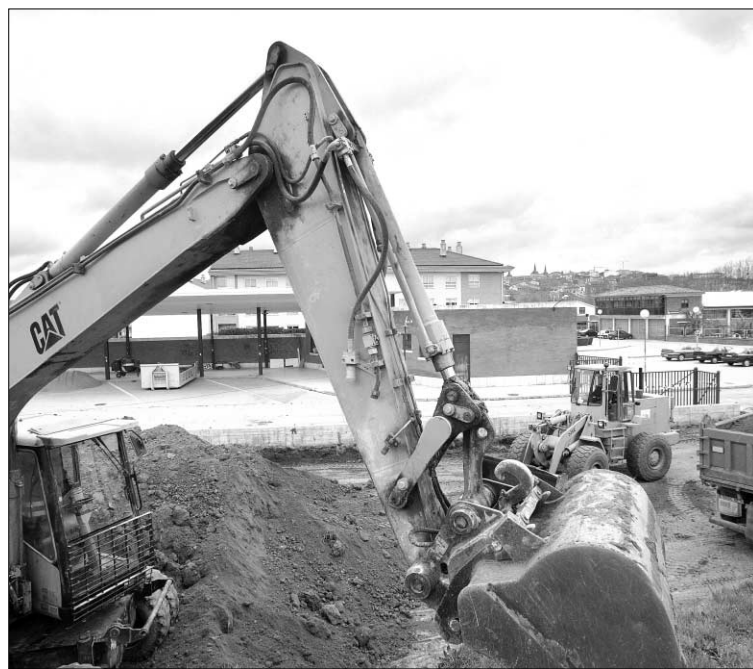
Imagen de archivo de las obras de la estación de autobuses de Lerma (Burgos). / A.R.
