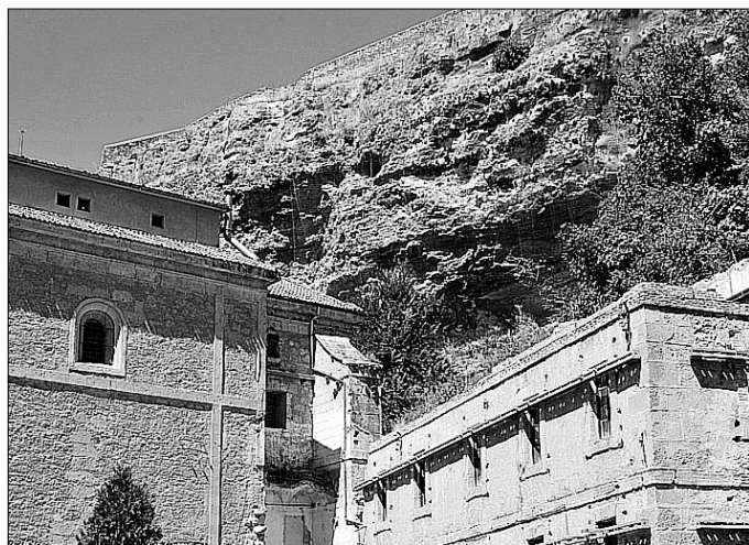
Zona consolidada tras el desprendimiento producido en 2005. / KAMARERO
