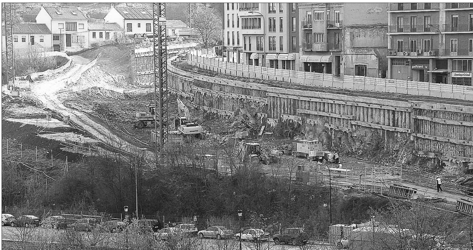
Los trabajos han culminado ya la mayor parte de la excavación. Se calcula que el parking, de 542 plazas, pueda ser plenamente operativo a finales de 2008.
