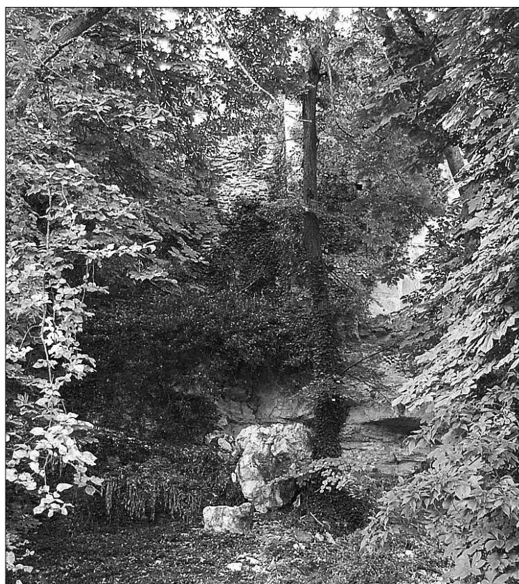
Imagen de las rocas que se desprendieron de un cubo de la muralla.
