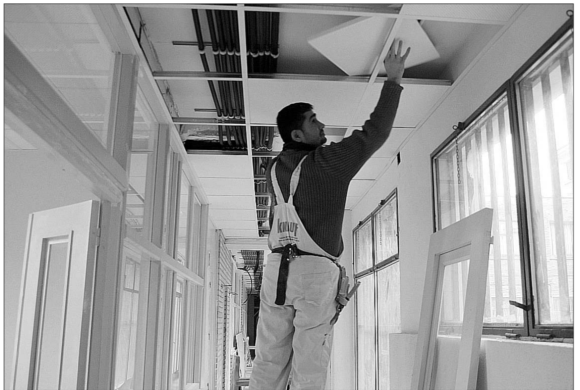
Los trabajos contemplan la reforma integral de los locales, que suman unos 400 metros cuadrados. / PEÑALOSA
