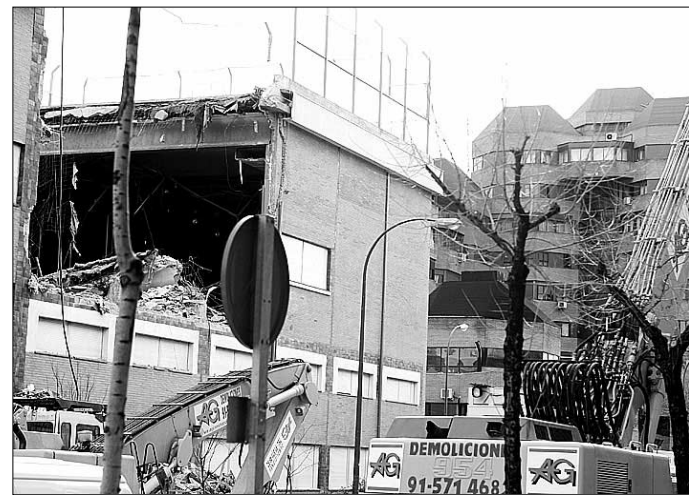
La parte del colegio que sufrió el derrumbe data de 1982. / EFE
