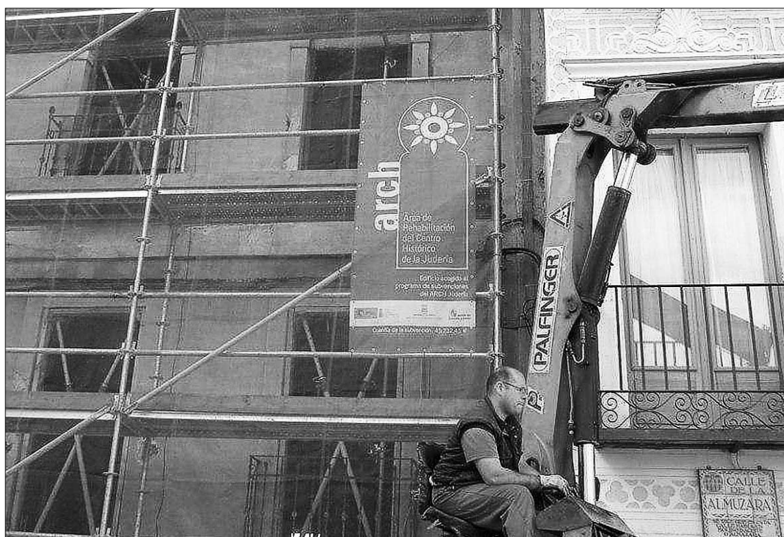
Imagen de una vivienda en rehabilitación en la calle Daoiz, beneficiaria del ARCH de la Judería. / EL ADELANTADO
